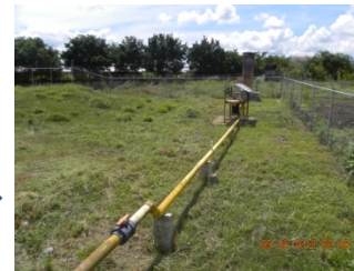
Conducción del biogás
